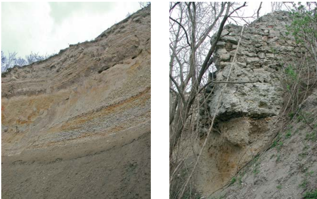
Abb. 157–158: Donauabbruch zwischen Petronell und dem Carnuntiner Legionslager: Die absturzgefährdeten Mauern befinden sich in unmittelbarer Nähe der von M. GROLLER freigelegten Reste des Statthalterpalastes ( praetorium ).
